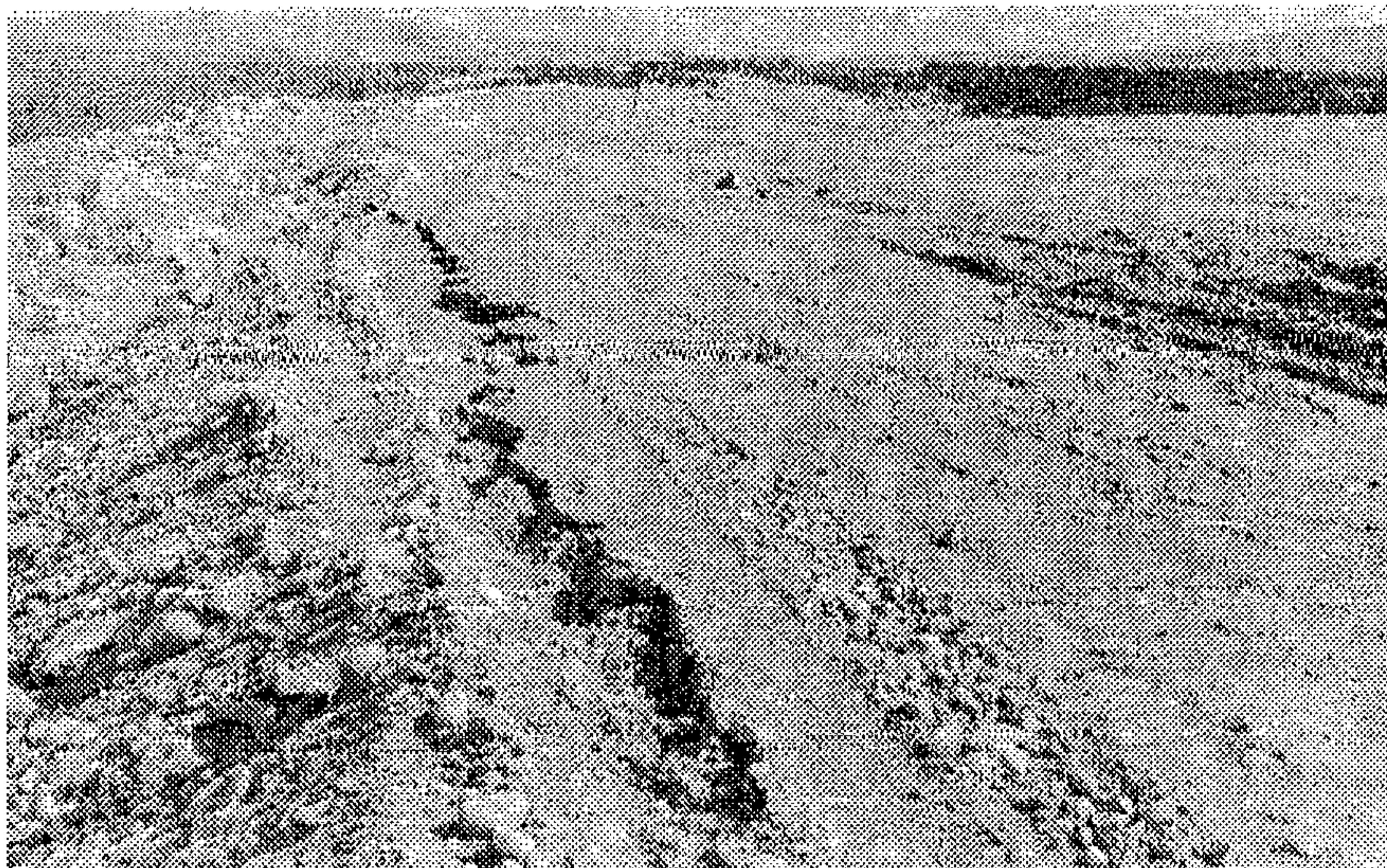
Рис.4.6. Пример формирования оползня на откосе плотины. Первичная трещина отрыва
