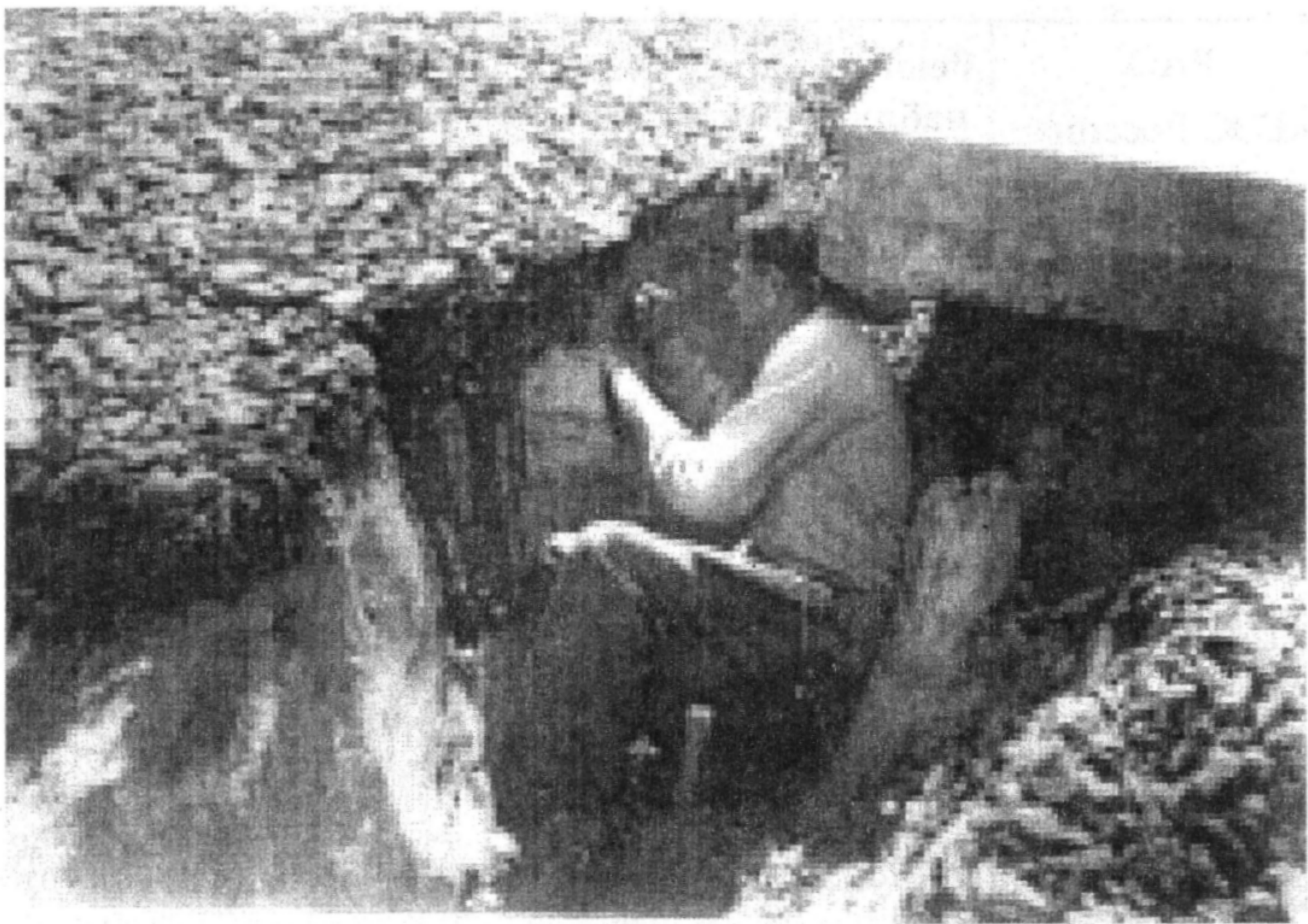
Рис.1. Сборные плиты с открытыми стыками, размер 2,5х4х0,25 м на сплошном обратном фильтре. Глубина размыва грунта в подплитной области около 80 см. Высота волн 3,2 м, расчетная 3,0 м.
