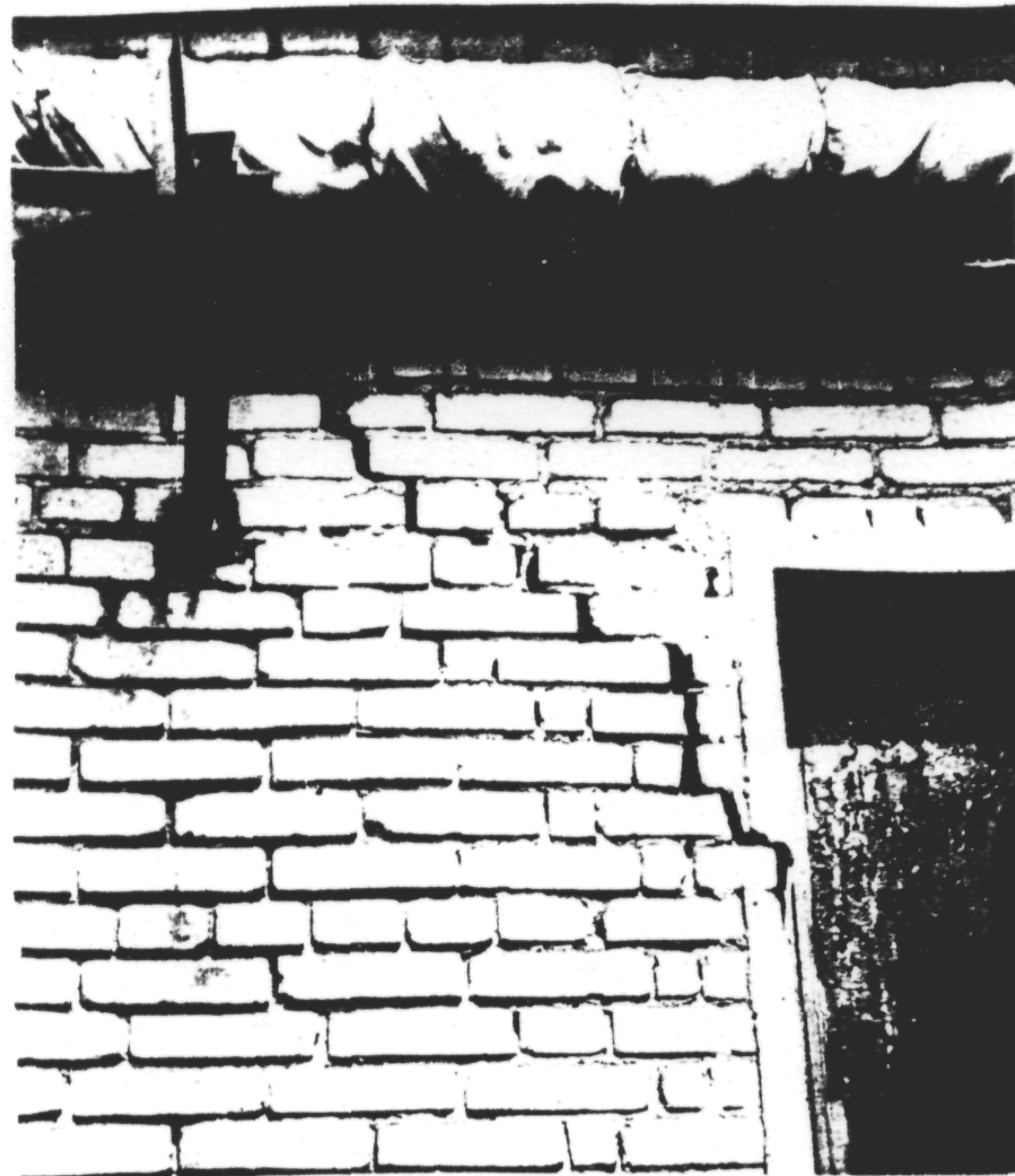
Рис. 12 Наклонная трещина в кирпичной стене по неперевязанному сечению
